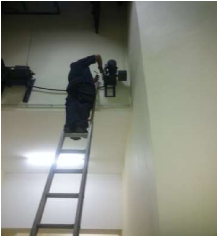
PENYELENGGARAAN SISTEM CURTAIN
